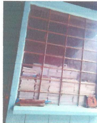
Foto 4: Ventanas selladas y en mal estado
