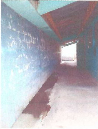
Foto 1: Se le dara mantenimiento al muro de contención del establecimiento ya que no esta en buenas condiciones por humedad y filtración de agua.
