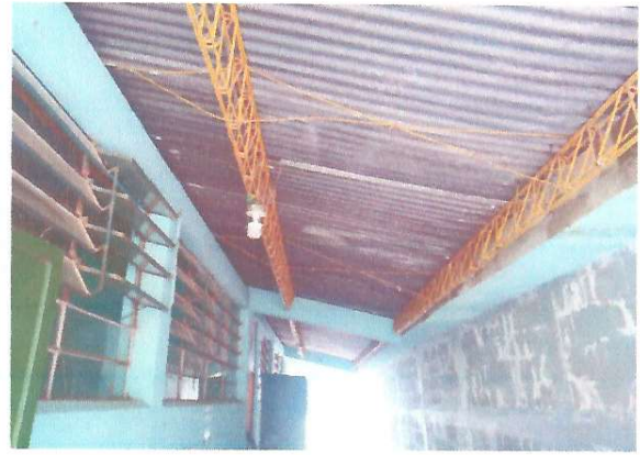
Foto 2: Se le dará mantenimiento a la cubierta de lamina de techo ya que se sufren filtraciones de agua en la estación de invierno.
