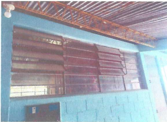
Foto 3: Mantenimiento de ventanal ya que hay vidrios quebrados y no se pueden abrir ni cerrar.
